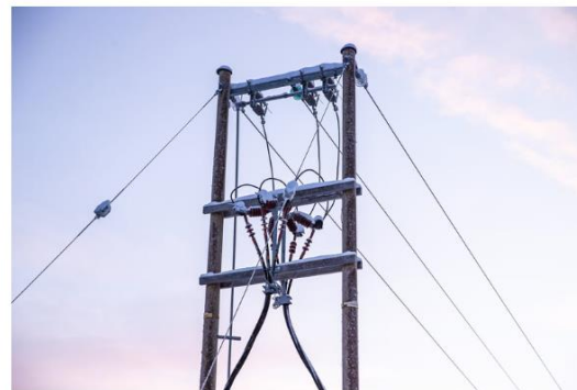
Harjoituksessa osallistujat ratkoivat kuvitteellista sähköjakelun häiriötilannetta. KUVA: JUSSI VÄÄTÄINEN
