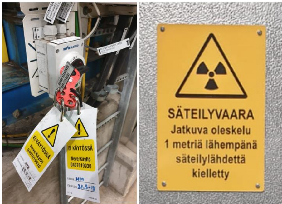
Kuva 7 Käyttövoimasta erottaminen ja säteilyvaarasta ilmoittava kyltti.
